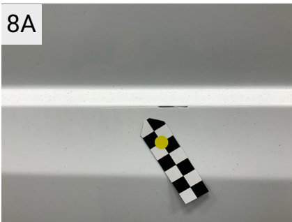
8A Sted H. bagdør Del Skydedør Type Ridser
