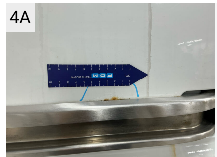
4A Sted H. bagskærm Del Skærm Type Rust plet
